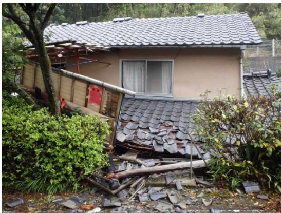
熊本地震の被災家屋（西原村）
